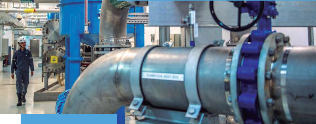
Một kỹ sư kiểm tra việc vận hành nhà máy sưởi ấm khu vực.
