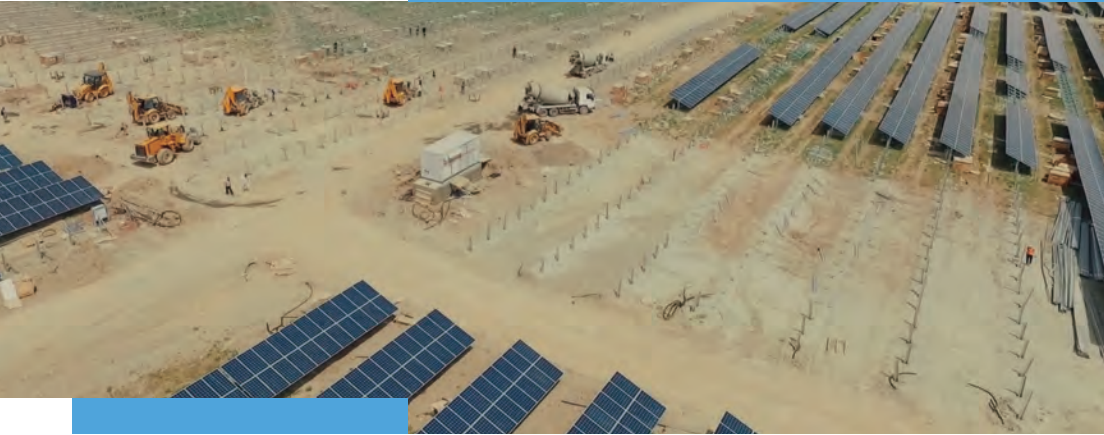
Các pin quang điện được lắp đặt tại Nam Ca-dắc-xtan (ảnh của Công ty TNHH Baikonyr Solar).
